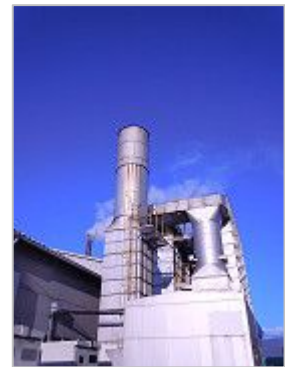
アルミニウム工場集塵機
